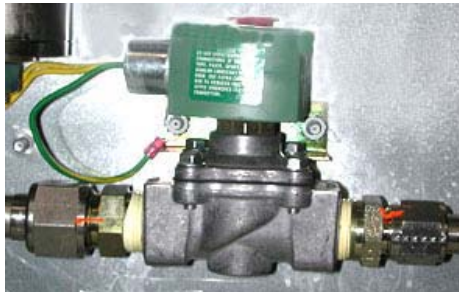
Рисунок 21 Электромагнитный отсечной клапан и газовый фильтр
