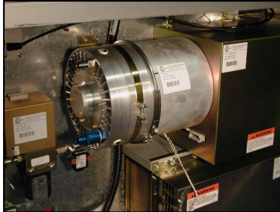
Рисунок 30 Встроенный дожимной газовый компрессор - контроллер дожимного газового компрессора (рис.31)
