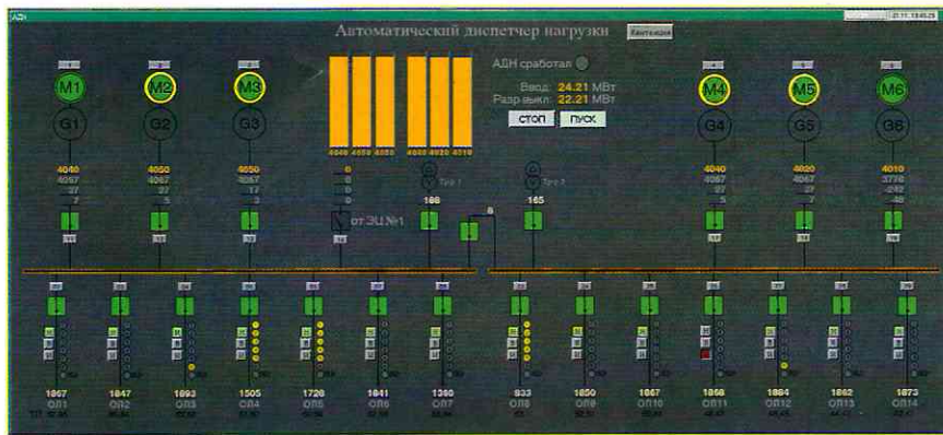
Вид панели оператора ЗРУ 10 кВ
