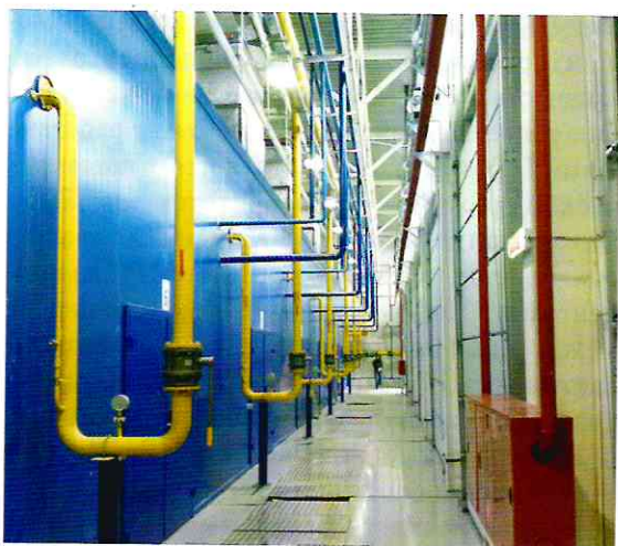
Энергоблоки на станции размещаются в шумозащитных кожухах
